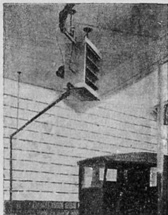
Общий вид термолиерной установки
